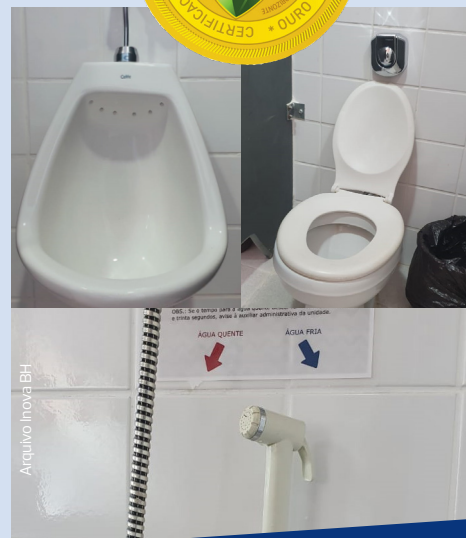
Mictórios, válvulas de descarga e chuveiros com regulagem de pressão garantem o Selo BH Sustentável para as Emeis da Inova BH
